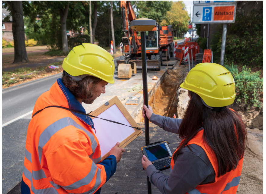
Das Büro Geotechnik führt Leitungsvermessungen für Ver- und Entsorgung und Telkos durch. GeoMapper unterstützt bei der Lieferung von Daten und dem Erstellen von Fachkatastern.
